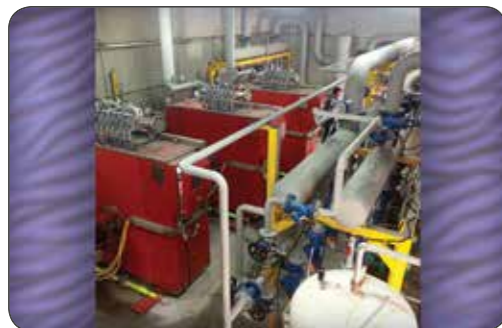
Condensing Boiler Arta Jooje Farm (Ardebil)
